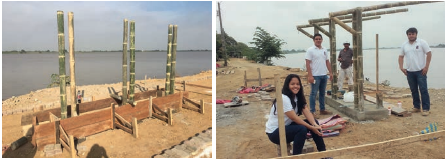
Figura 22. Proceso de construcción del área recreativa paisajística al borde del río Babahoyo
